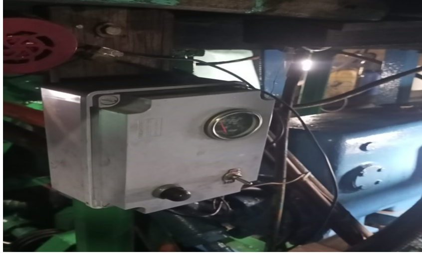
Sistem Start Pada Generator KM.Sumber Natuna
